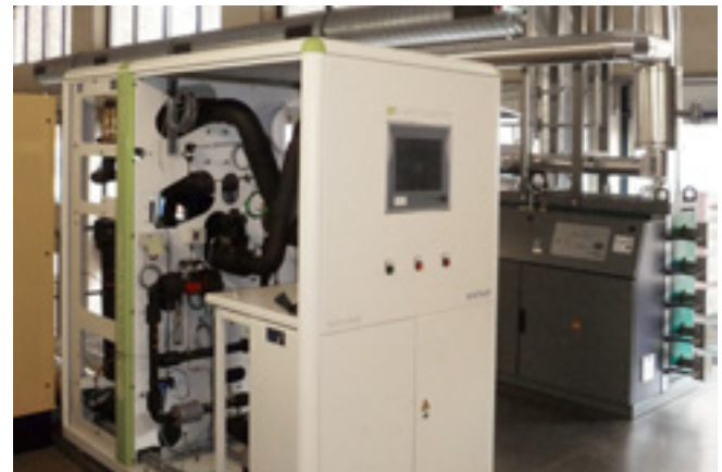
Die ORC-Versuchsanlage kann Abwärme in elektrische Energie umwandeln.
